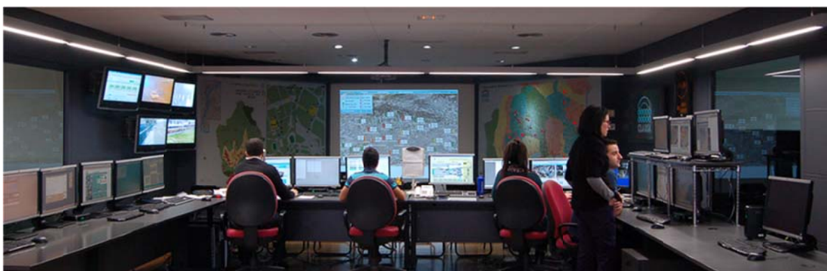
Figura 22: Exemple de Centre de Control del clavegueram de Barcelona
